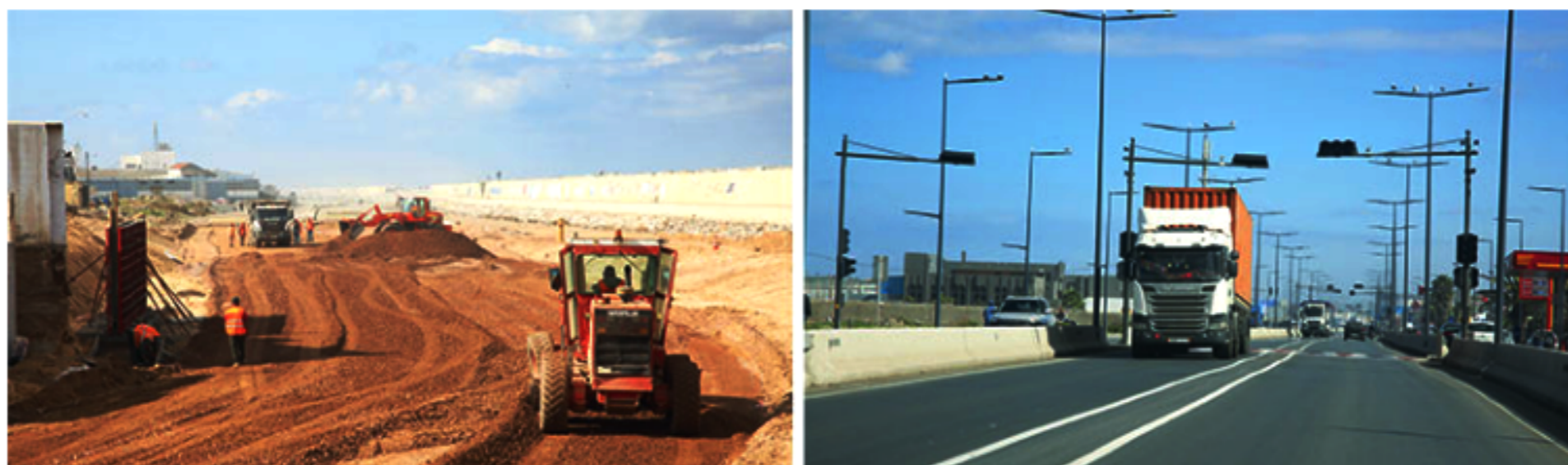
Les travaux de voiries ont repris il y a quelques semaines sur un tronçon de la desserte nord dont le but est d'organiser et de fluidifier la circulation du trafic des camions poids lourds (conteneurs) entre la zone logistique et le port de Casablanca (Ph. Khalifa)
